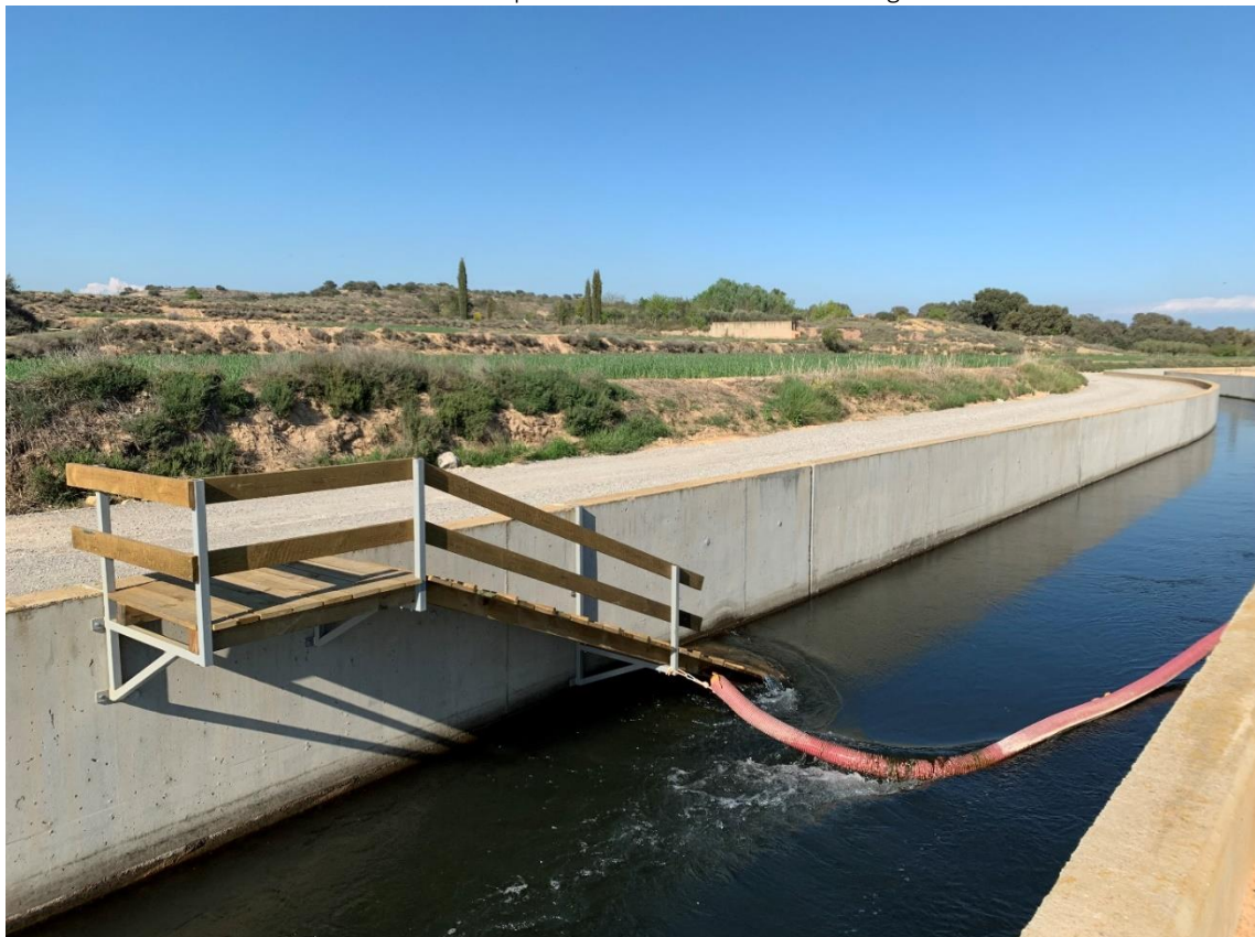
Foto 10. Mostra de rampa de salvament de fusta i acer galvanitzat.
