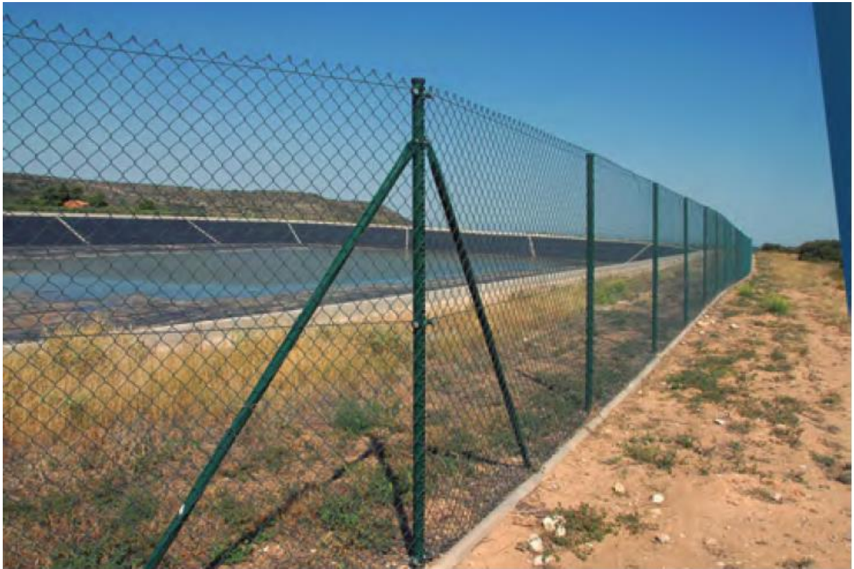
Foto 6. Tancament perimetral per evitar l'accés de vertebrats de mida mitjana i gran.
