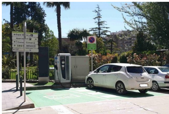
Figura 14. EDRR 50 kW. Les Borges Blanques (les Garrigues). 2021. Propietari: Ajuntament. Gestió: Etecnic. Font: Electromaps
