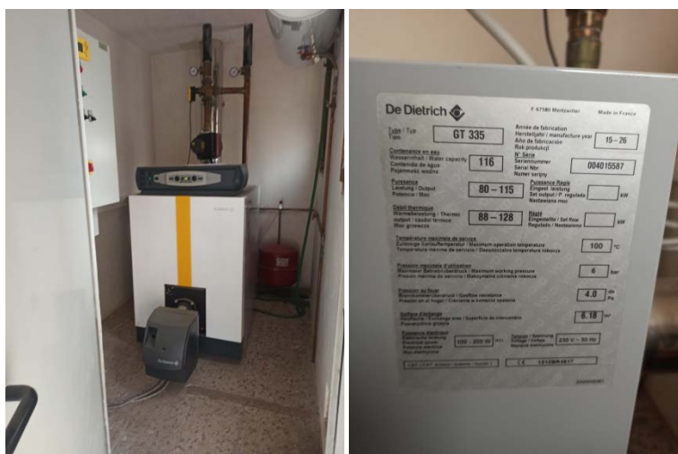
Figura 8. Caldera de Gasoil de la Sala de Reunió i Ball i característiques tècniques
