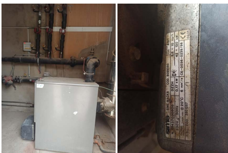
Figura 7. Caldera de Gasoil de l'Escola El Roser i característiques tècniques
