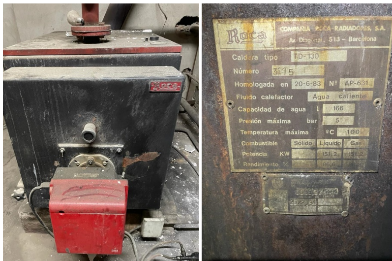
Figura 5. Caldera de Gasoil de l'Escola Jaume Miret i característiques tècniques
